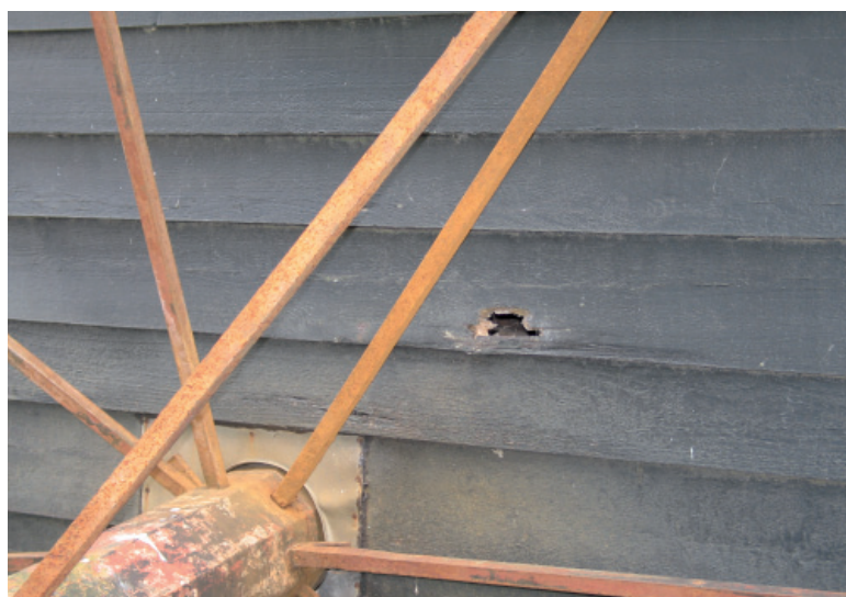
Afb. 16. Teken van houtrot in het potdekselwerk en corrosievorming op het water-rad.
