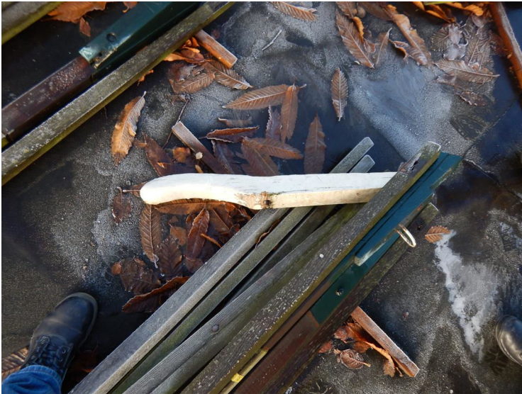
Ingerot houtwerk Kluften en roeden.
