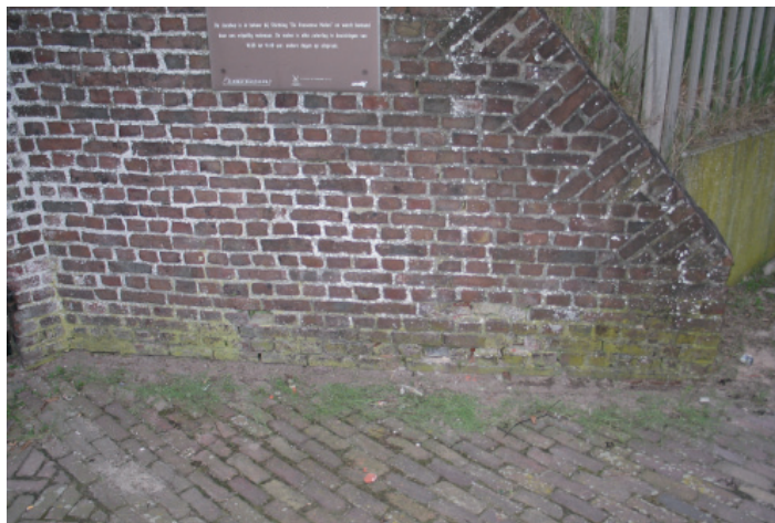
Afb. 12. "De Jacobus" in Vessem – Geërodeerd voegwerk ter plaatse van de toog.
